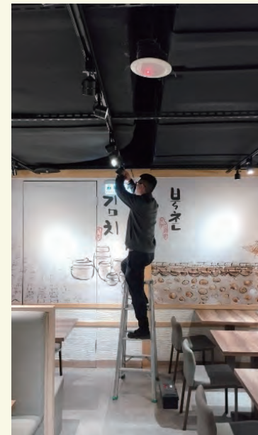
► 檢查照明電源是否正常
